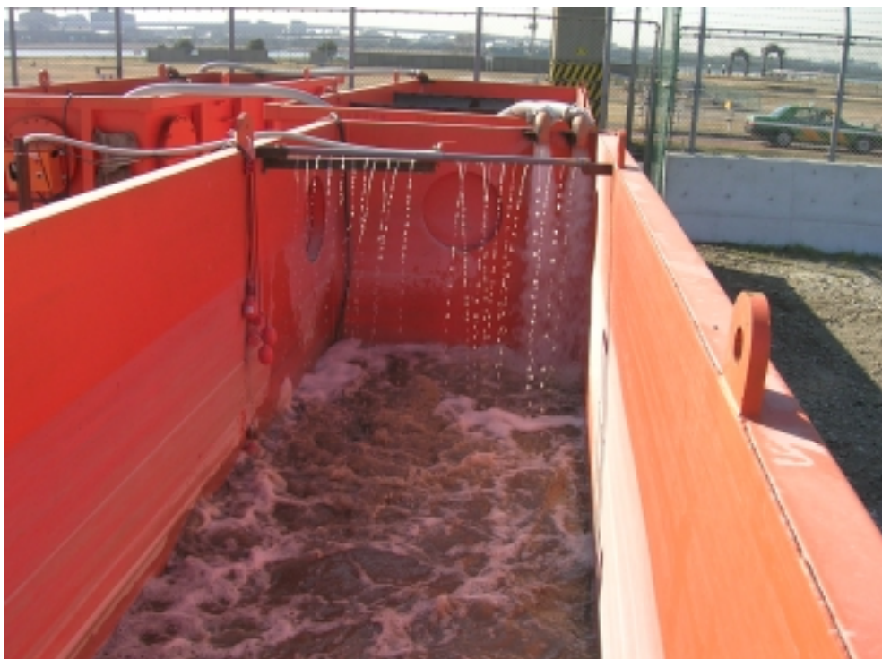
排水プラント 使用状況(中和剤散布)
